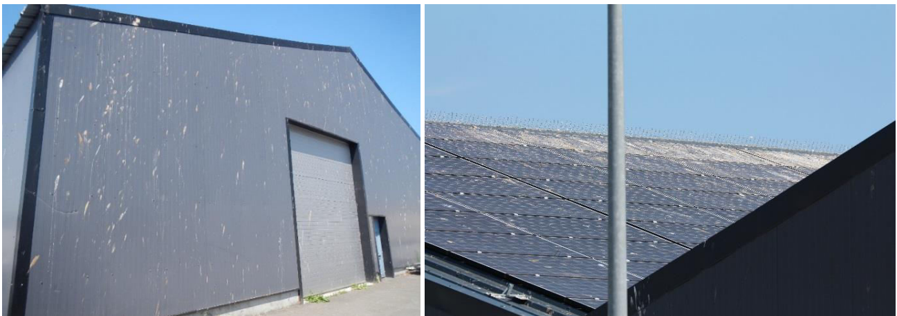
Figure 6 : Fientes de goélands sur bâtiments et panneaux solaires – Photos TBM environnement
