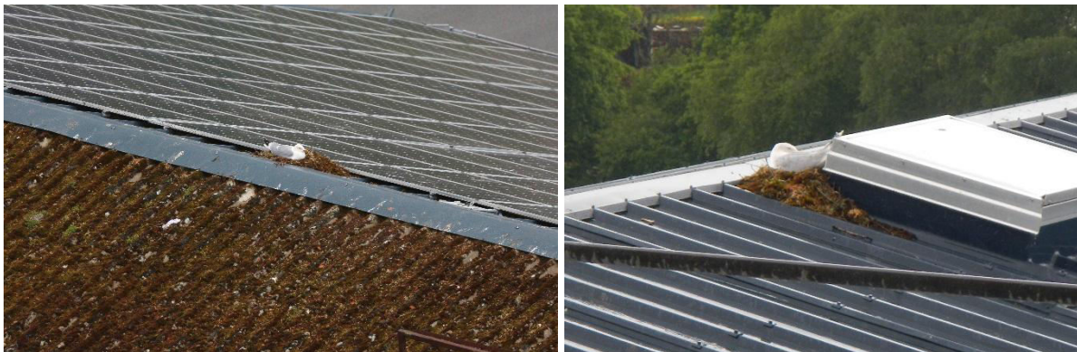
Figure 7 : Nids de Goéland argenté sur toit en bac-acier – Photos TBM environnement
